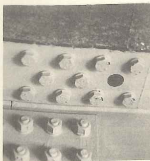
写真-1 フランジ部のボルト折損例 (高速道路高架橋)
